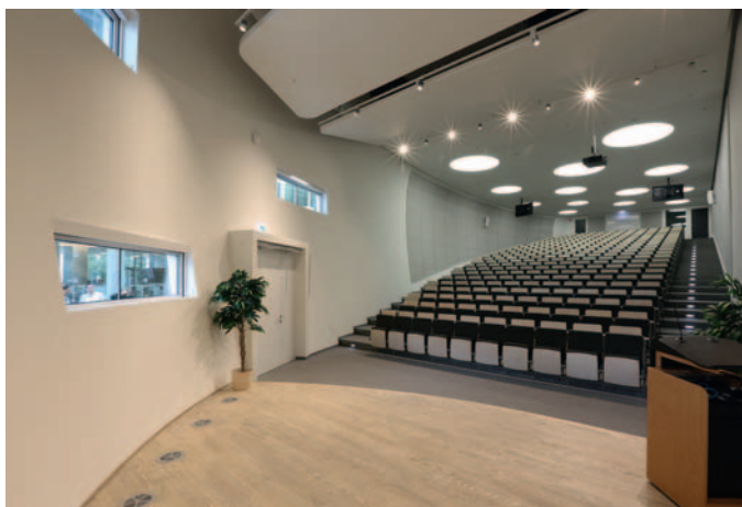
Обзор круглой аудитории Maximim на стадии выполнения отделочных работ (Фото: Knauf / Halama)
