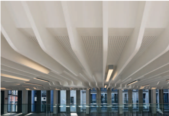
Совершенная интеграция потолочного короба в интерьер посредством установленных на ребро и уходящих вверх ламелей
